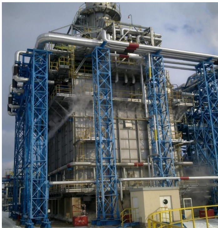
Рисунок 1.7 – Общий вид трубчатой печи П–301/1 С–300/1 [Привод. по: 99]
